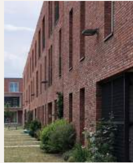
Verlichting aan de gevel
